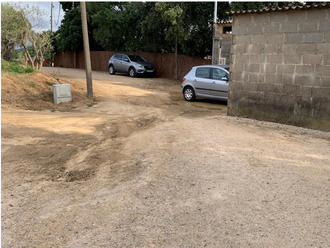
Diferencials de cota que impedeix el drenatge natural abocant l'aigua al gual
